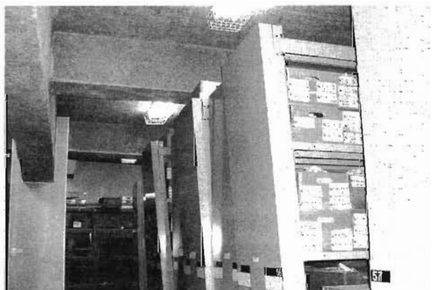
ハンドル式移動棚のゆがみ（3階収蔵庫）
